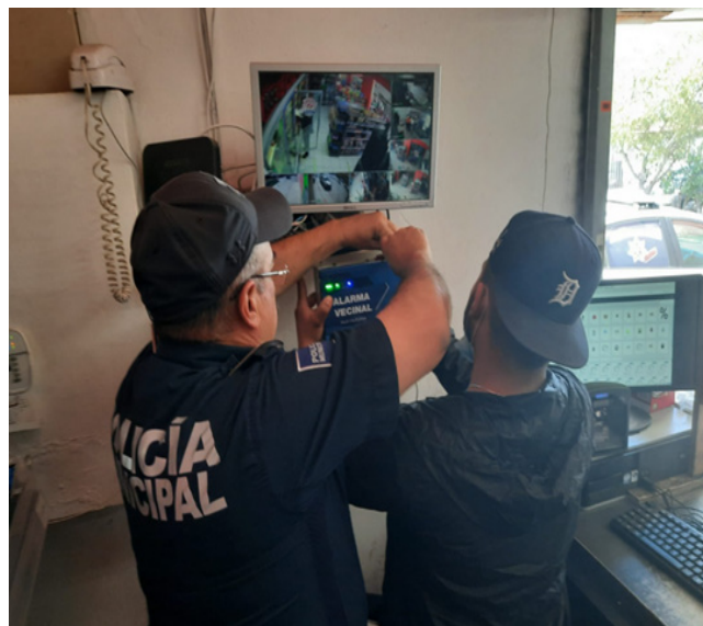
Instalación de alarma vecinal.
